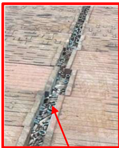
敷板に生じる隙間 危険！
